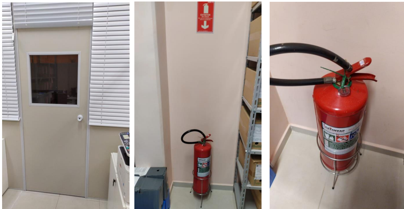
Imagem 11, 12 e 13: Entrada do Arquivo e parte interna com extintor de incêndio corretamente sinalizado e com data de validade de junho de 2021.
