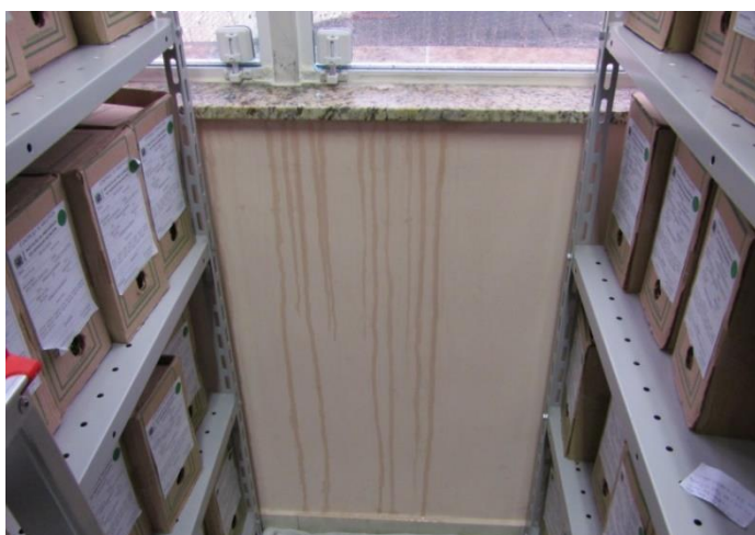
Imagem 1: Peitoril da janela com infiltração da chuva.
